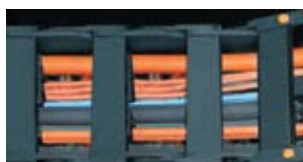
Cable Veyor내 정상 설치 사진
